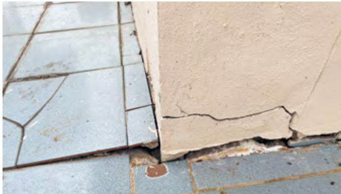
Balkonabdichtungen sollten genau überprüft werden
