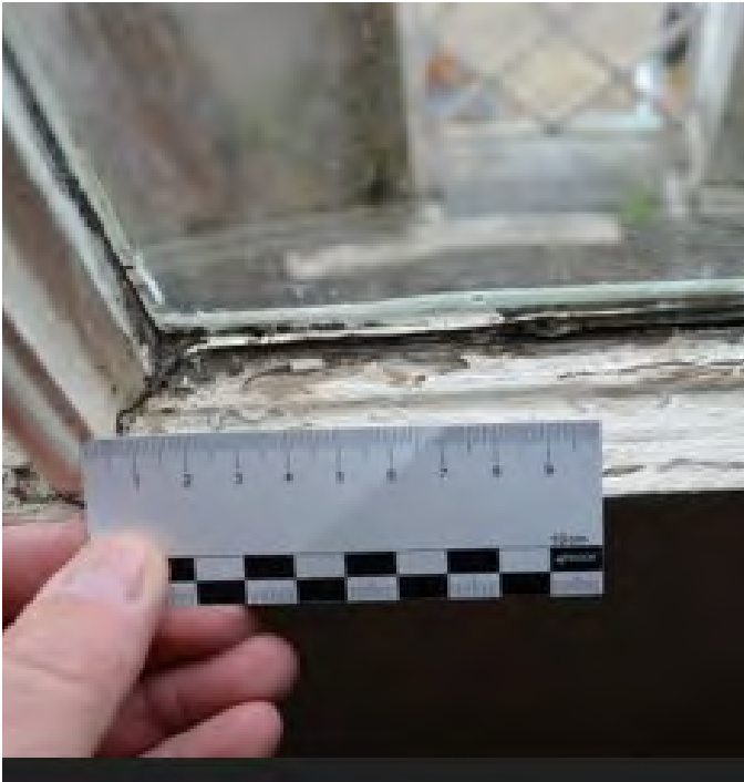
Einfachverglasung und Kondensatschäden - ein häufiges Bild im Altbau
