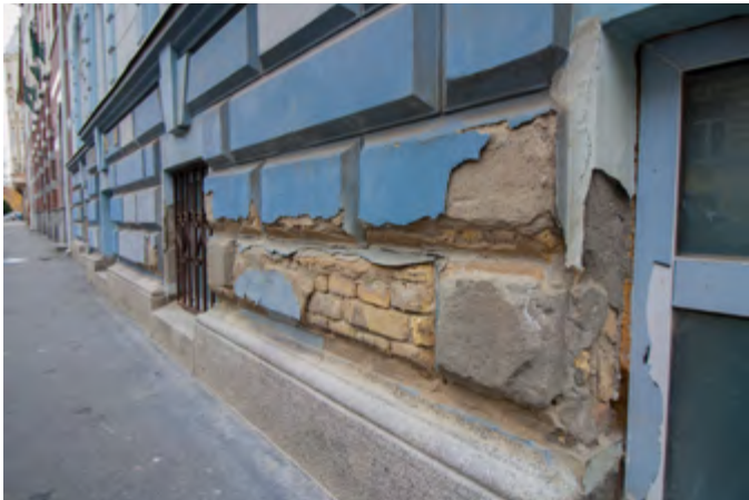
Defekte Bauwerksabdichtungen und aufsteigende Feuchtigkeit, vor dem Verputzen muss die Abdichtung erneuert werden
