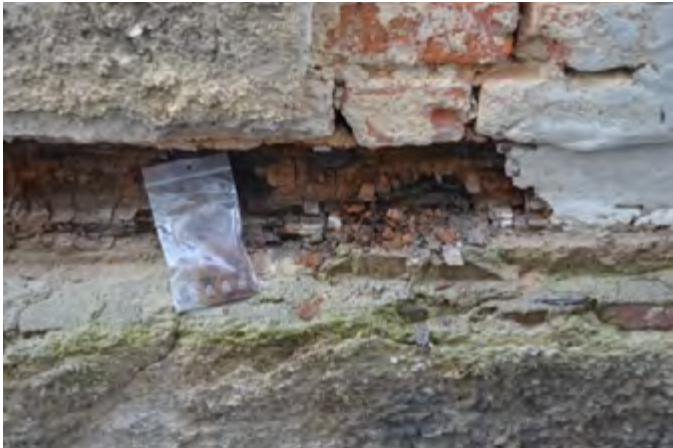
Bauteileöffnungen durch den Bausachverständigen – Holz lebt, aber leider auch die Pilze durch Bausünden in der Vergangenheit
